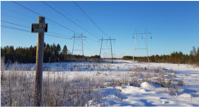
Sähköasema ja voimalinjat Humpinmäentieltä avautuvissa näkymissä.
